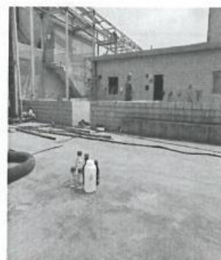
混酸废水处理前
