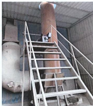
球磨粉碎车间提升机顶部布袋除尘器出口
