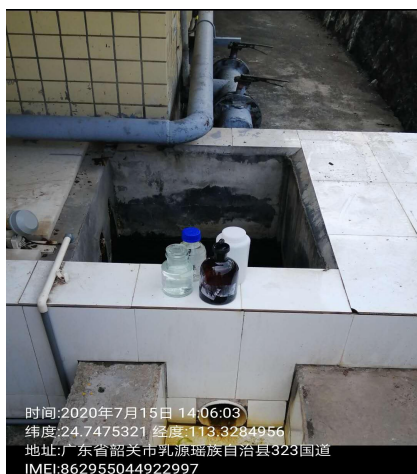
处理站废水排放口
